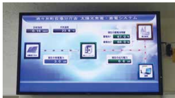
太陽光発電の状況が見えるモニター (役場分庁舎)
